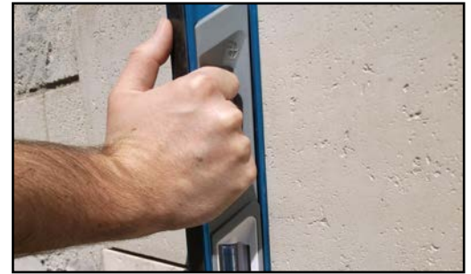
Use un nivel grande para verificar y mantener un plano de cara uniforme sobre distintas losetas.
